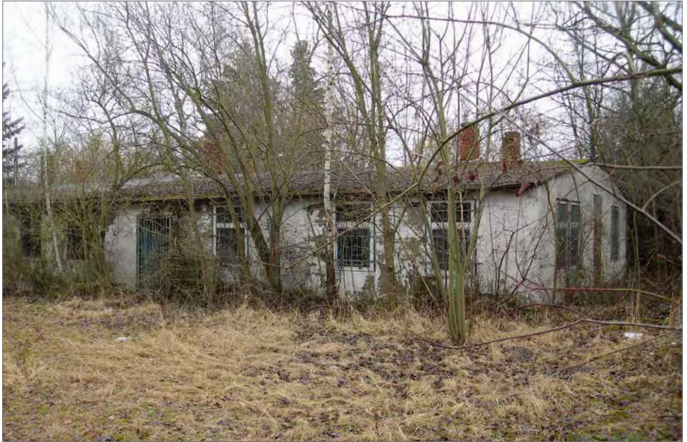
Abbildung 5: Mittweida, die ehemalige Wachbaracke verfällt auf einer Brachfläche. (Foto: LfA Sachsen, M. Strobel)
