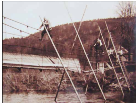
Abbildung 31: Halsbrecherische Reparaturen nach dem Januarhochwasser 1932
